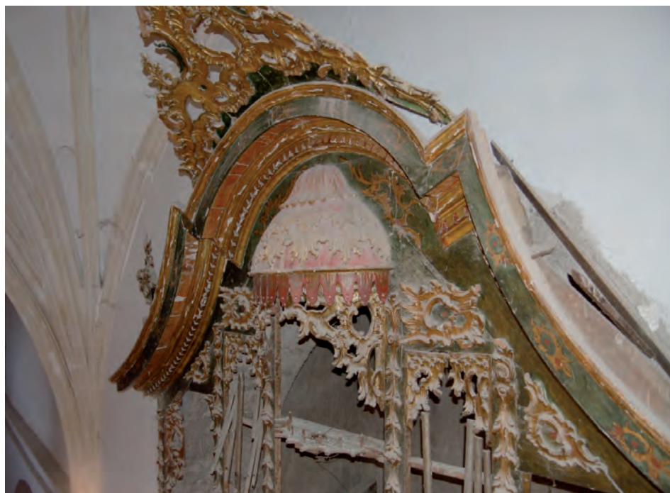
Estado actual de la cornisa y dosel, obra de los maestros tallistas José Castell y Juan de Rivas, y del dorador Gabriel Mira. (Foto: G. González).
